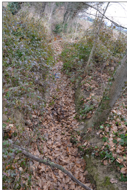
F4 Interno del canale di implivio
