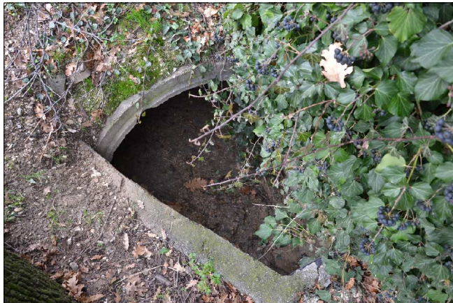
F5 Particolare tubo in cls parzialmente ostruito
