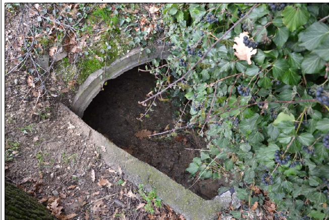
F5 Particolare tubo in cls parzialmente ostruito
